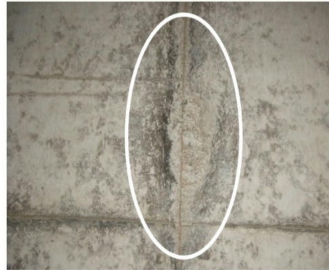
型枠継目のノロ漏れ
