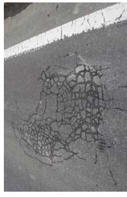
写真1 亀甲状のひび割れ
