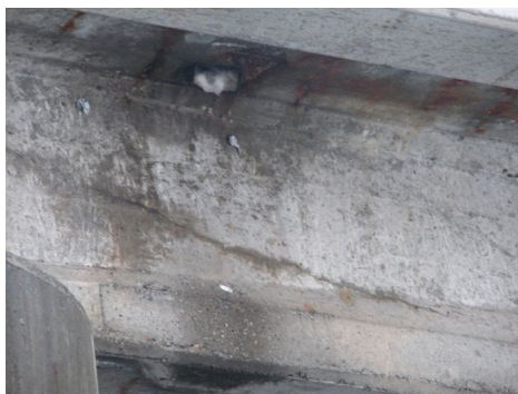
写一解 2.1.1 曲げ上げ PC 鋼材に沿ったひび割れ
