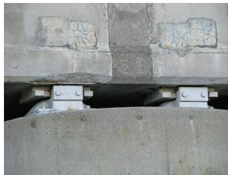
写一解 2.1.3 後埋めコンクリートの劣化
