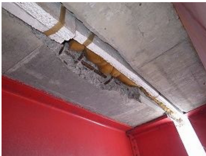
写一解 2.2.5 はつり箇所が完全に復旧されていない例
