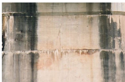
写一解 2.3.5 縦壁の水平ひび割れ例（橋脚）
