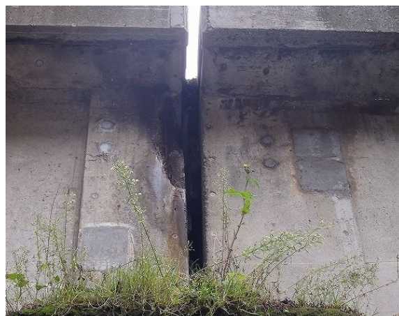
写一解 2.1.4 橋面からの塩分を含んだ漏水による桁端部の腐食の発生
