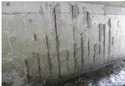
写一解 2.3.18 塩害 (鉄筋露出)
