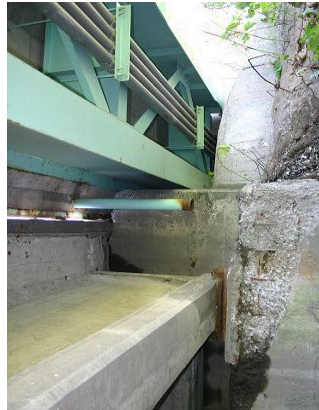
a-1変状例 (排水不良により滞水、変状あり)
