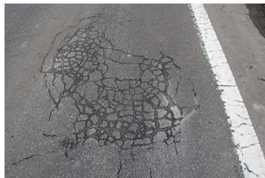
(b) ひび割れ 写一解 2.2.1 舗装面の変状
