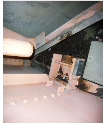
a-2変状例 (排水不良により滞水あり)
