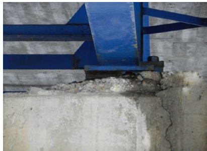
写一解 2.3.11 支承アンカーからのひび割れ
