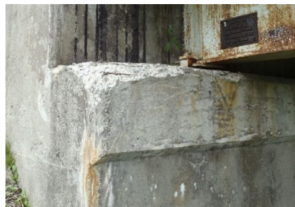
写一解 2.3.16 凍害(2) (骨材露出, 剥落)
