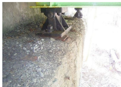
写一解 2.3.21 支承周辺の変状例 (沓座の凍害)
