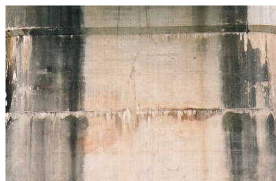
写真一解 2.3.25 堅壁の水平ひび割れ例
