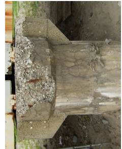
写真c-1(3) 凍害 (上梁・沓座)
