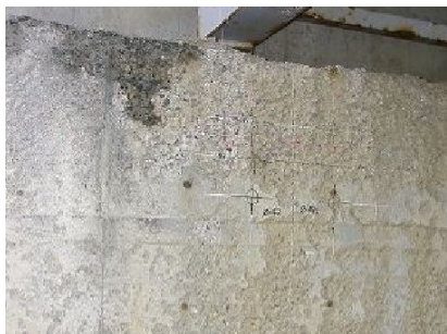
写一解 2.3.15 凍害(1) (スケーリング)
