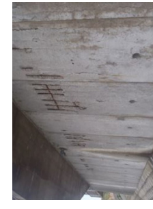
写真c-3(2) 塩害の例 (橋台)
