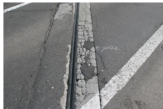
写一解 2.2.3 コンクリート部のひび割れ
