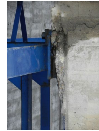
写真b-7(1) 支承アンカー位置からのひび割れ
