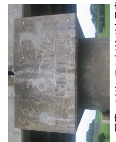
写真c-2(2) アルカリシリカ反応 (上梁側面、沓座付近)
