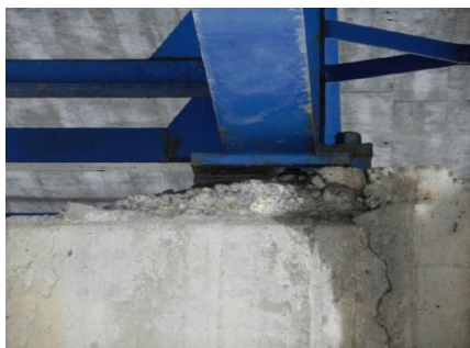
写一解 2.3.1 支承周辺の変状例 (沓座せん断ひび割れ)
