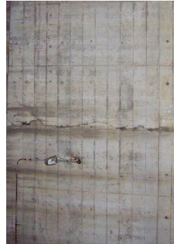
写真a-3(2) 縦壁の鉛直ひび割れ
