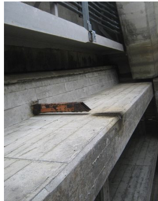
a-1変状例 (排水不良により変色あり)
