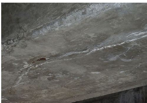
写一解 2.1.10 PC 桁の下フランジに発生したひび割れ
