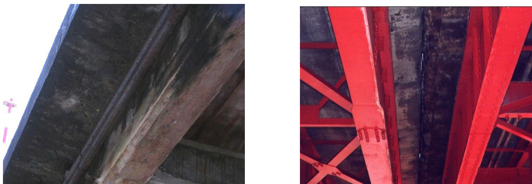
写一解 2.4.14 床版の水切り機能の不備による水かかりの例
