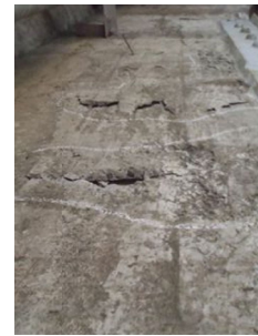
写真c-4(1) 中性化 (橋台-堅壁)
