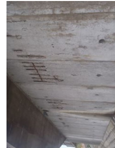
写真c-3(2) 塩害 (橋台-堅壁前面)
