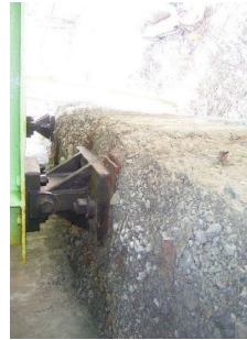
写真c-1(3) 凍害 (沓座、壁前面)
