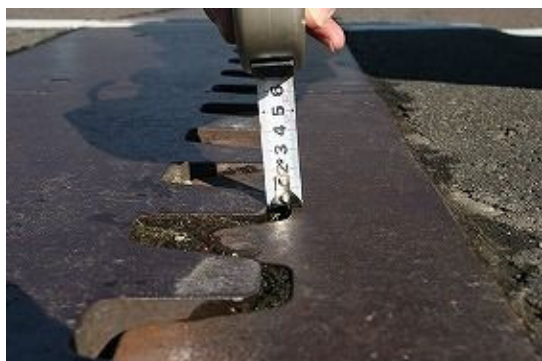
写一解 2.2.2 伸縮装置の段差
