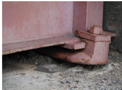
写一解 2.3.12 支承機能不全 沓座モルタル変状
