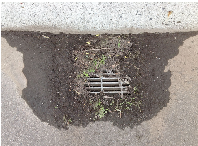
写一解 2.2.6 排水柵の土砂詰まりの例
