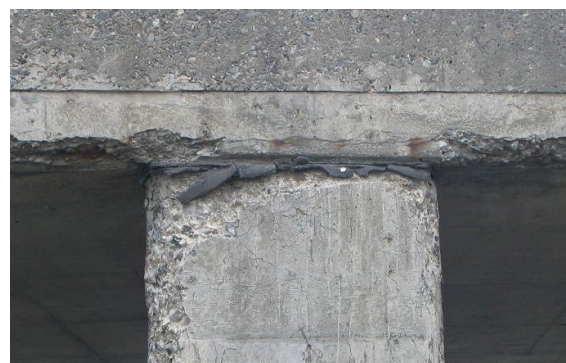
写一解 2.1.6 ゴム支承の劣化の例
