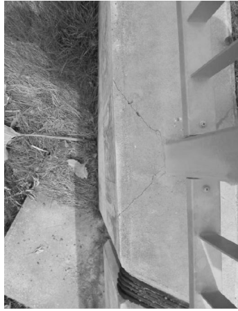
変状例(支柱の変形)
