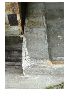
写真c-1(1) 凍害 (胸壁、沓座付近)
