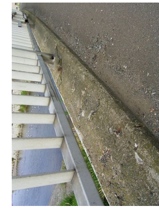
c-4変状例 (塩害) 腐食ひび割れ ・部分的剥離
