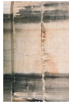
写真a-4(2) 水平ひび割れの例 (壁式橋脚-コールドジョイント)
