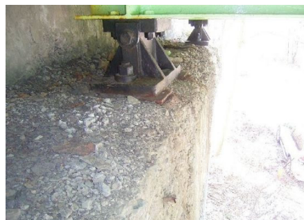
写一解 2.3.2 支承周辺の変状例 (沓座の凍害)
