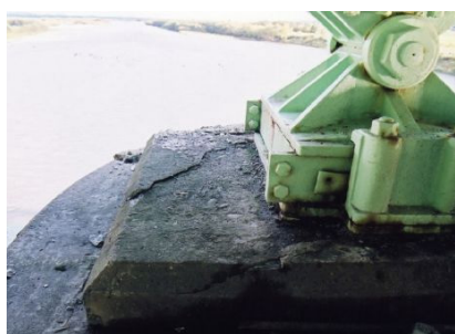
写一解 2.3.13 沓座モルタル変状
