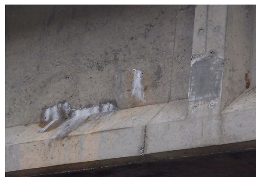
写一解 2.1.11 PC 桁の下フランジ側面に発生したひび割れ
