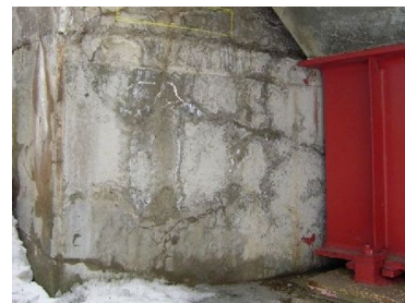
写一解 2.3.19 アルカリシリカ反応 (不規則ひび割れ)
