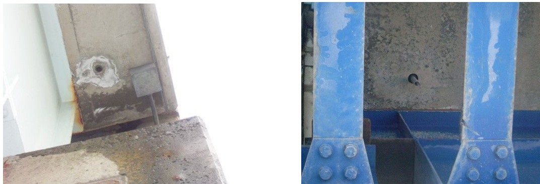
写一解 2.4.13 床版排水の流末位置の不備による水かかりの例
