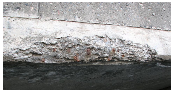
写一解 2.1.5 凍害によって張り出し床版側面に生じたスケーリングの例
