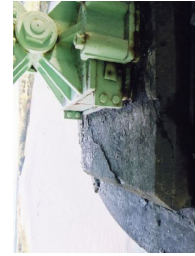
写真b-8(3) 省座モルタルの変状
