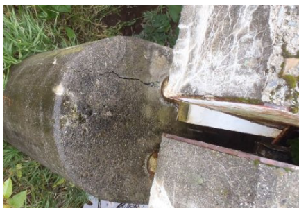
写一解 2.3.20 支承周辺の変状例 (沓座せん断ひび割れ)
