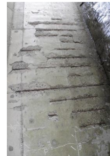
写真c-3(1) 塩害 (橋台-堅壁)
