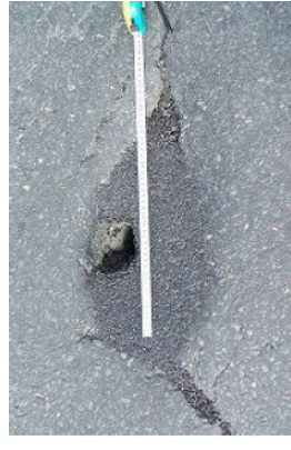
写真2 ポットホール
