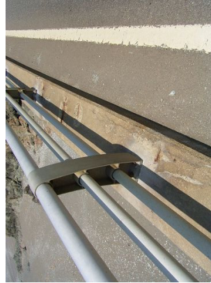
c-4変状例 (塩害) 腐食ひび割れ ・部分的剥離
