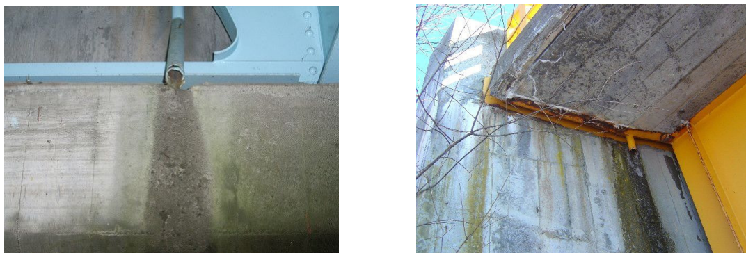
写一解 2.4.15 伸縮装置の排水機能の不備による水かかりの例
