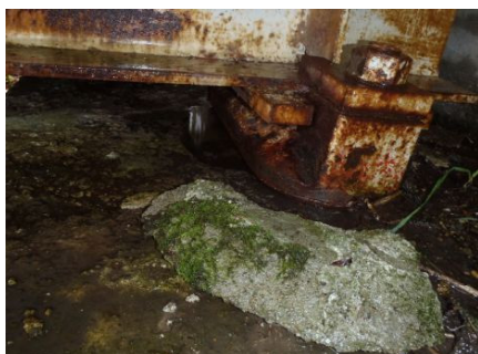
写一解 2.3.22 沓座の滞水と変状例 (沓座モルタルの変状)
