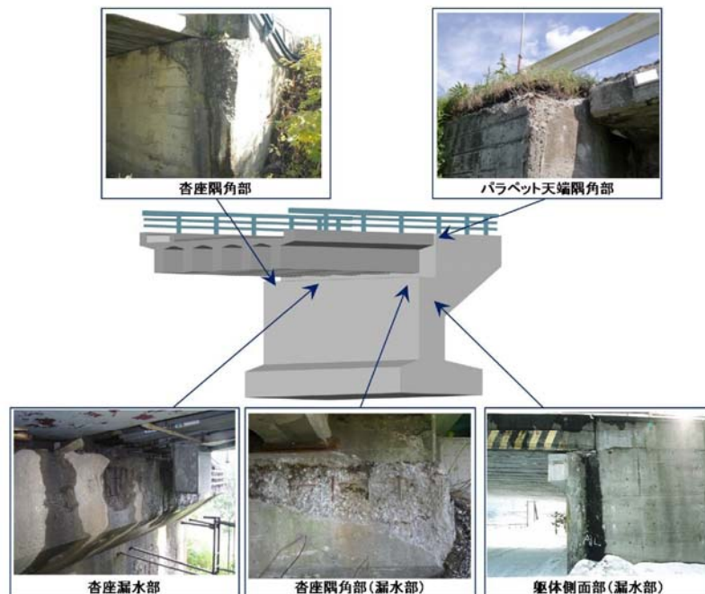
図 4.3.5 道路橋の凍害による劣化事例(5/8) 橋台
