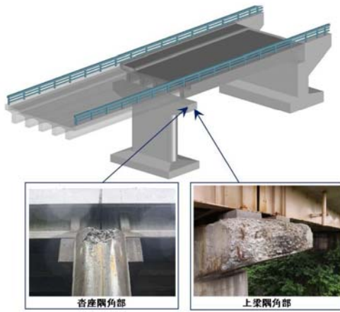
図 4.3.6 道路橋の凍害による劣化事例 (6/8) 橋脚①
